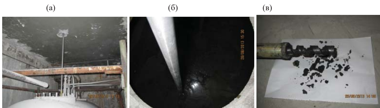
Рис. 3. Отбор проб донных отложений из емкостей: заведение пробоотборника в емкость через верхние перекрытия (а); погружение пробоотборника в слой донных отложений (б); шнековая насадка устройства после отбора проб и извлечения (в).
