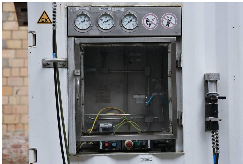
Водородная заправочная станция
