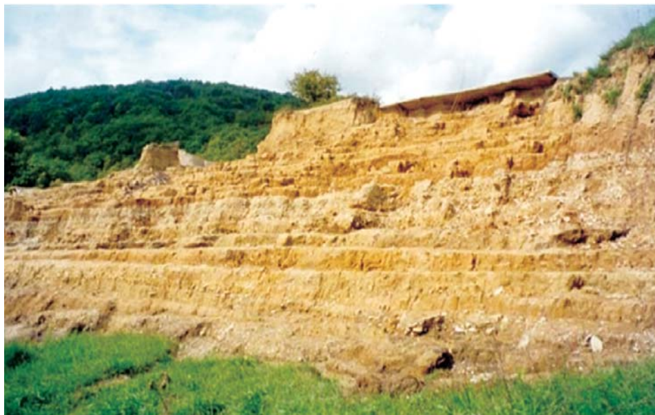
Рис. 4.1.2. Разрушение плотины на р. Дюрсо (высота плотины 25 м, длина по гребню 215 м), вид со стороны нижнего бьефа (фото В.В. Беликов)
