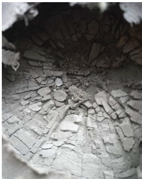
Рис. 4. Разрушение керамики “Идеал”.
