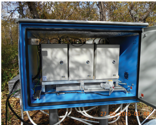
Рис. 1. Фотография всепогодного антивандального приборного шкафа в п. Начики (Камчатка) с пятью микробарометрами, системой воздуховодов для локальной сверки/калибровки микробарометров и подключения ветровых фильтров, многоканальным блоком оцифровки и передачи данных на удаленный сервер.
